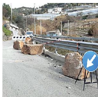
I massi caduti lungo la strada
